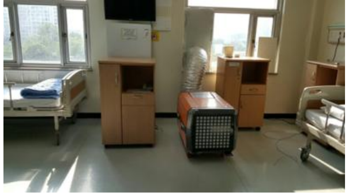
이동형 음압장비 설치
